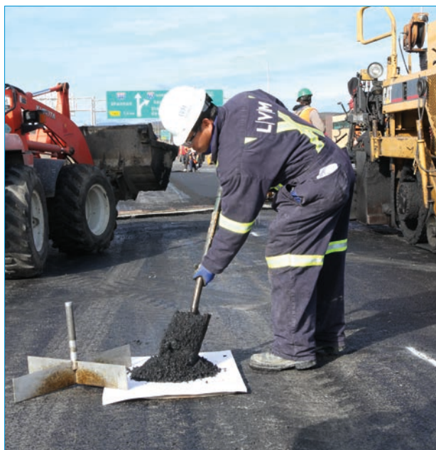
■ Asphaltage du tablier du pont au-dessus de la rivière Lorette sur l'autoroute Henri-IV, à Québec. Prélèvement et échantillonnage d'enrobé bitumineux sur chantier.
