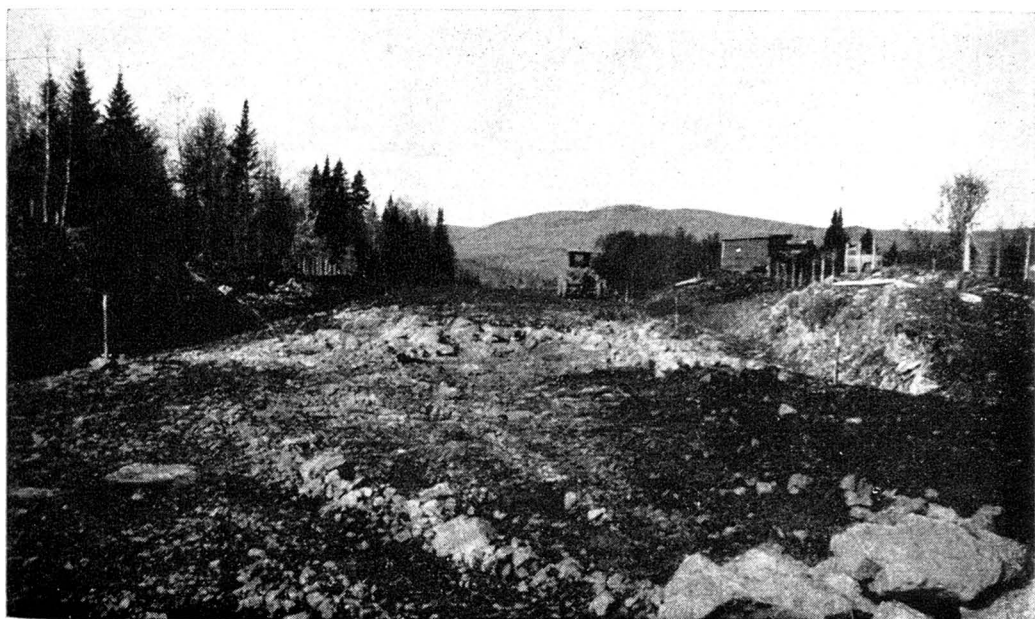
Travaux de construction exécutés, en 1955, sur la nouvelle route entre Notre-Dame-des-Laurentides et Stoneham.
