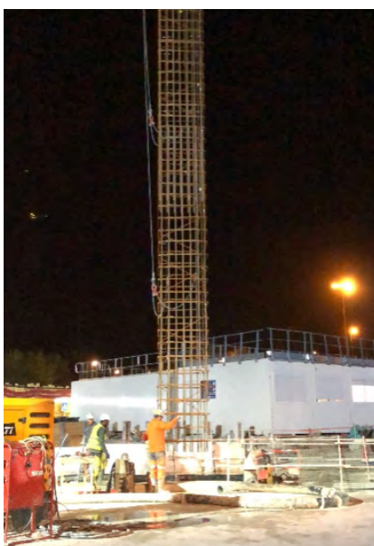
OA13 (ligne 15 du Grand Paris Express) - ferrailage équipé par fibres optiques en cours d'installation dans une paroi moulée
