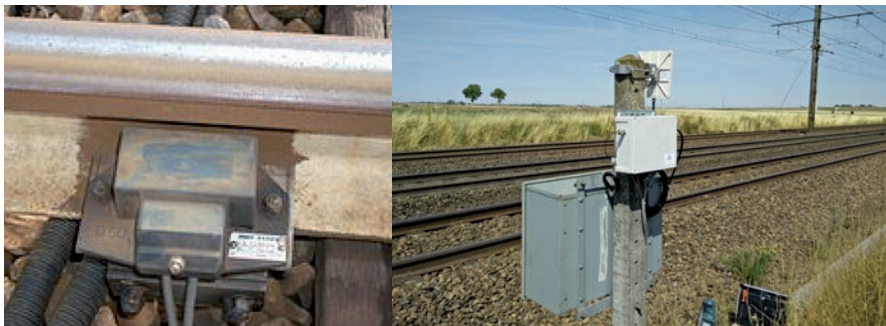
Instrumentation de deux compteurs d'essieux sur la ligne Paris-Orléans par des briques et des algorithmes de l'Ifsttar
