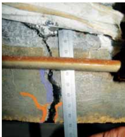
EXEMPLES DE FISSURATION DE BÉTONS
