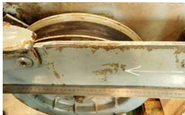
ÉLÉMENTS MÉTALLIQUES ENDOMMAGÉS
