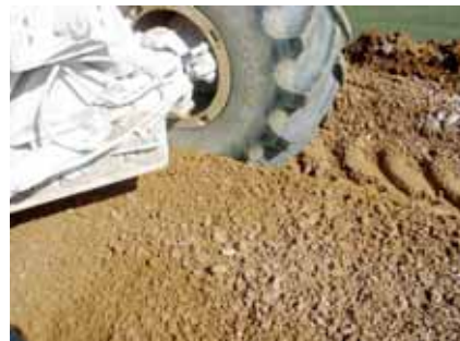
EXAMEN DES SOLS ARGILEUX TRAITÉS À LA CHAUX
