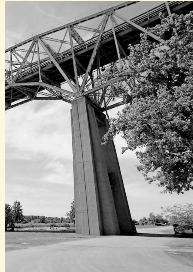
Le pont du chenal Nord qui relie la ville de Cornwall à l'île de Cornwall au pont international de la voie maritime ou « Croisée des Trois Nations », sera remplacé par un pont à travée basse.
