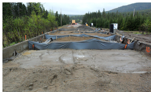
Vue d'ensemble des différentes sections en construction et des membranes étanches utilisées pour séparer et isoler les sections
