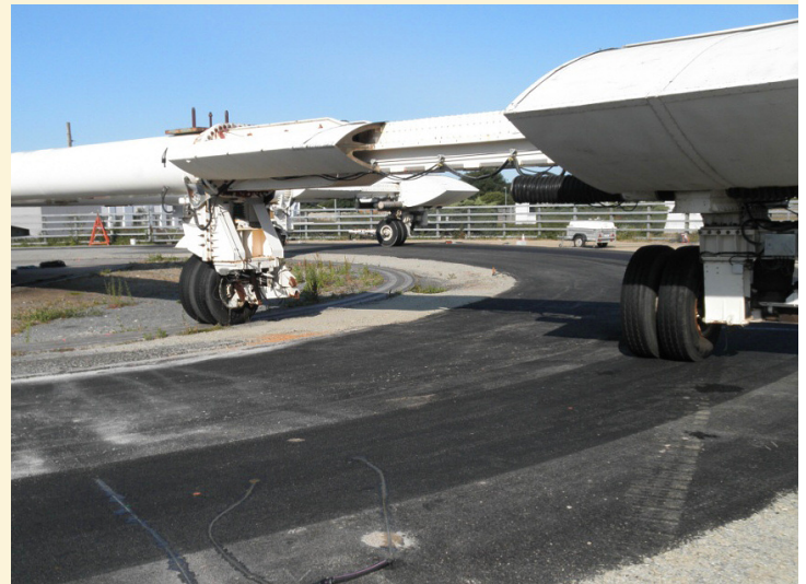
Jauges de mesures de déformation à fibres optiques de l'université Laval installées dans le sentier de roue du manège de fatigue à Nantes (France) pour l'évaluation de l'effet des pneus sur la chaussée.
