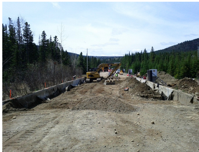
Travaux de préparation de la fosse d'essai pour la construction de 5 planches expérimentales visant à évaluer l'efficacité de systèmes de drainage de la chaussée.
