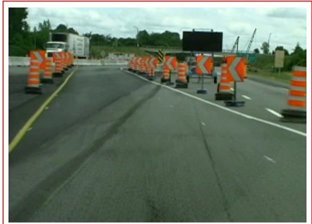
Mauvaise utilisation des repères visuels, mélange des chevrons de direction et T-RV-7
