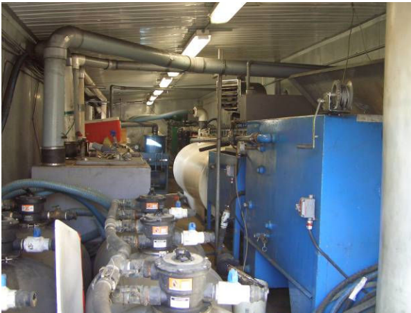
Système d'extraction des hydrocarbures au site St-Henri
