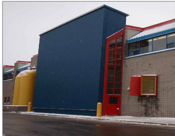
Mur solaire à l'atelier GR
