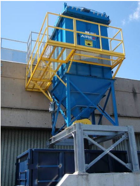
Dépoussiéreur de l'atelier des pneus au centre de transport Legendre
