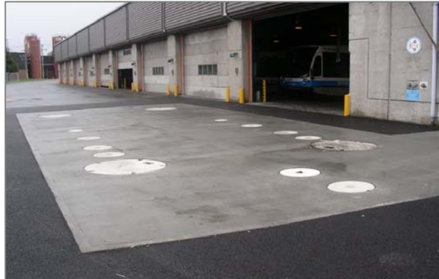
Réservoirs de diesel souterrains - CT St-Laurent
