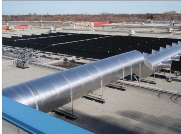
Panneaux solaires sur le toit des ateliers de la GR
