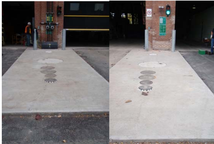
Réservoirs de diesel souterrains- Centre de transport Frontenac
