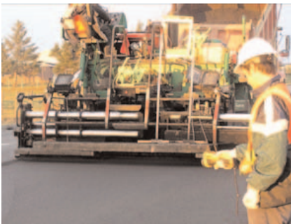
Figure 7-5 Suivi de la mise en place d'enrobé bitumineux avec une caméra à infrarouge
