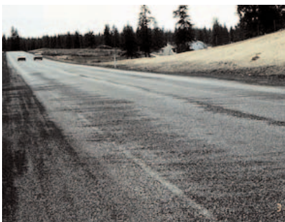
Figure 8-2 Température variable au moment du compactage conduisant à de l'arrachement
