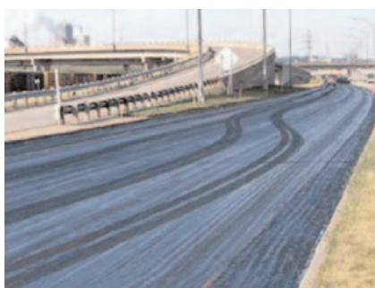
Figure 3-7 Épandage non uniforme du liant d'accrochage
