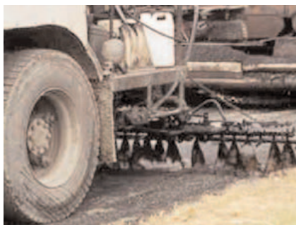
Figure 3-5 Liant d'accrochage mal distribué
