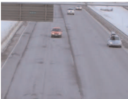
Figure 2-11 Ségrégation d'un revêtement
