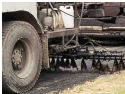
Figure 3-6 Liant d'accrochage mal distribué
