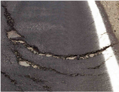
Figure 3-1 Glissement de la couche d'enrobé
