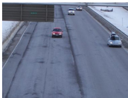
Figure 2-11 Ségrégation d'un revêtement
