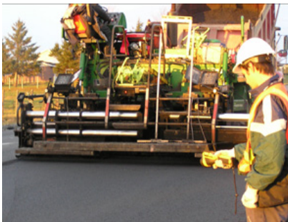
Figure 7-4 Suivi de la mise en place d'enrobé bitumineux avec une caméra à infrarouge
