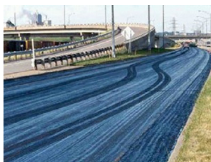
Figure 3-8 Épandage non uniforme du liant d'accrochage
