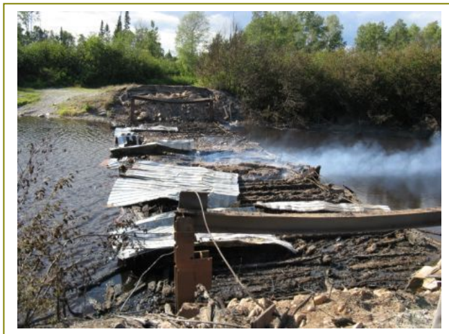
Ce qu'il en restait après l'incendie
