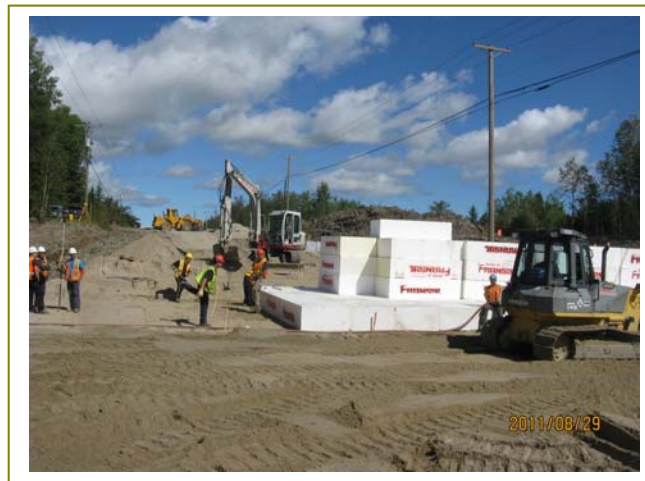
Remplacement d'un ponceau au-dessus du cours d'eau Lamarre sur la route 393 entre Palmarolle et La Sarre
