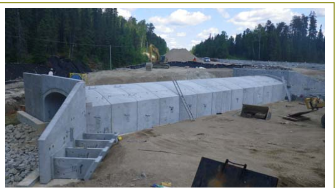
Ci-dessus : reconstruction d'un ponceau au-dessus du ruisseau Jackson À gauche : réfection du pont au-dessus de la décharge du lac Beak
