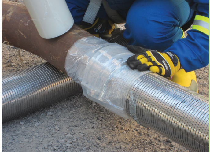
Détail du joint de transfert pneumatique du chlorate de sodium.
