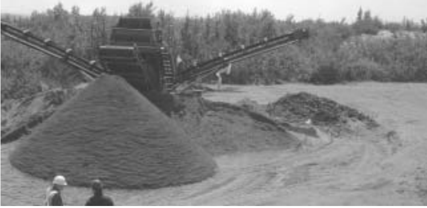
Projet de décontamination d'un site aéroportuaire: tamisage et tri des sols et déchets.
