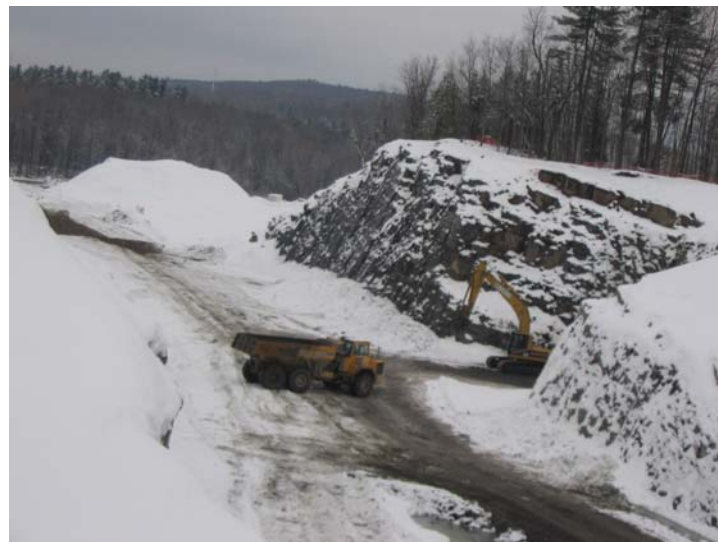
Janvier 2006 - Des travaux de dynamitage réalisés, de décembre à février, ont permis de dégager le boulevard et les bretelles d'accès à la promenade du parc de la Gatineau, facilitant ainsi l'accès de ce parc à tous les résidents de l'Outaouais.
