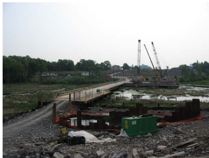
Vue du pont temporaire au-dessus du ruisseau des Fées au 31 mai 2006. Le pont temporaire a été aménagé afin de protéger le ruisseau des Fées : il sera défilé après la construction du pont qui enjambera le ruisseau.
