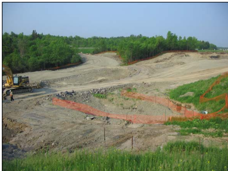
État des travaux à la jonction du futur boulevard Saint-Laurent et de l'actuel boulevard de l'Outaouais au 31 mai 2006
