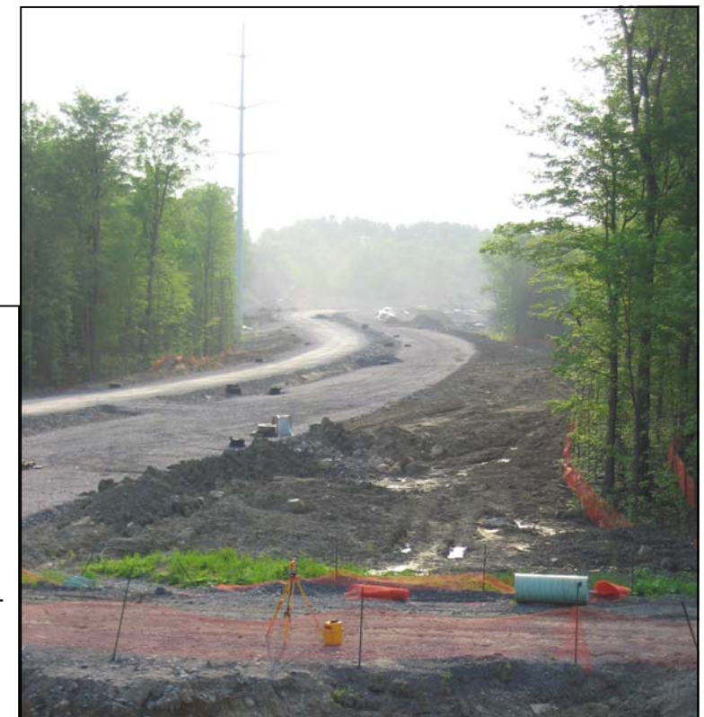
Vue des travaux en cours sur l'axe McConnell-Laramée depuis le viaduc du boulevard Saint-Raymond (vers l'est). Photo : Michel Marcotte
