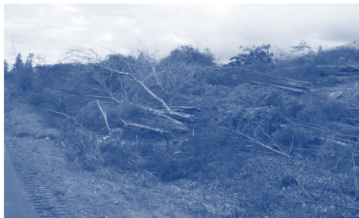
Des travaux de déboisement ont commencé dans les espaces nécessaires à l'aménagement de la future chaussée.
