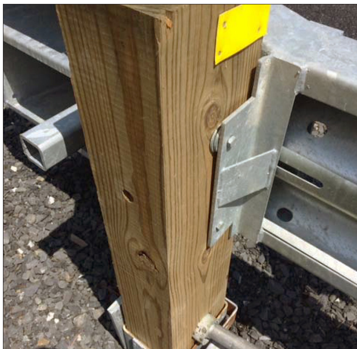
Figure 4 – Installation de la tête d'impact d'un dispositif d'extrémité ajustée avec des rondelles en acier.
