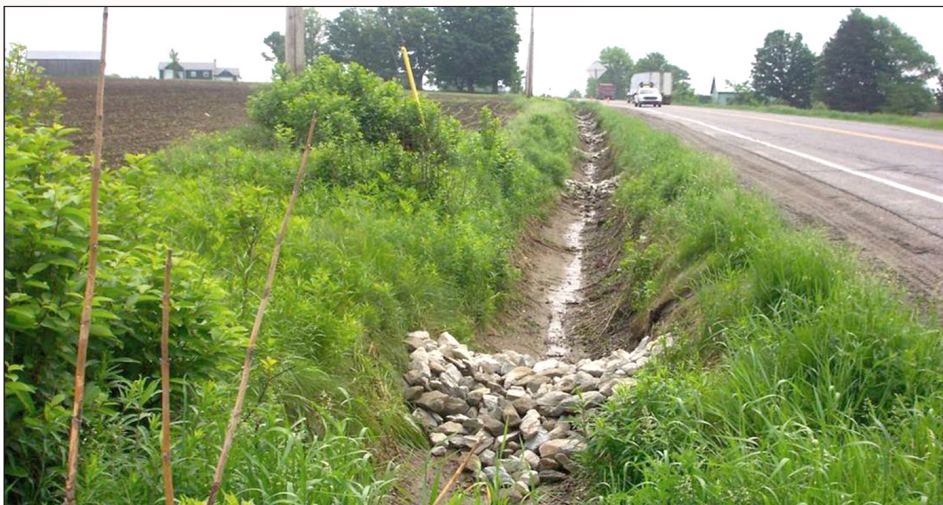
Photo 1 – Bannes de dissipation d'énergie en enrochement disposées en cascade dans un fossé latéral. Ces bannes ralentissent la vitesse de l'eau afin de réduire son potentiel érosif et captent une partie des sédiments. (Source : MTQ)
