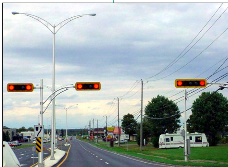
Photo 1 Illustration d'une installation électrique à un carrefour avec feux
