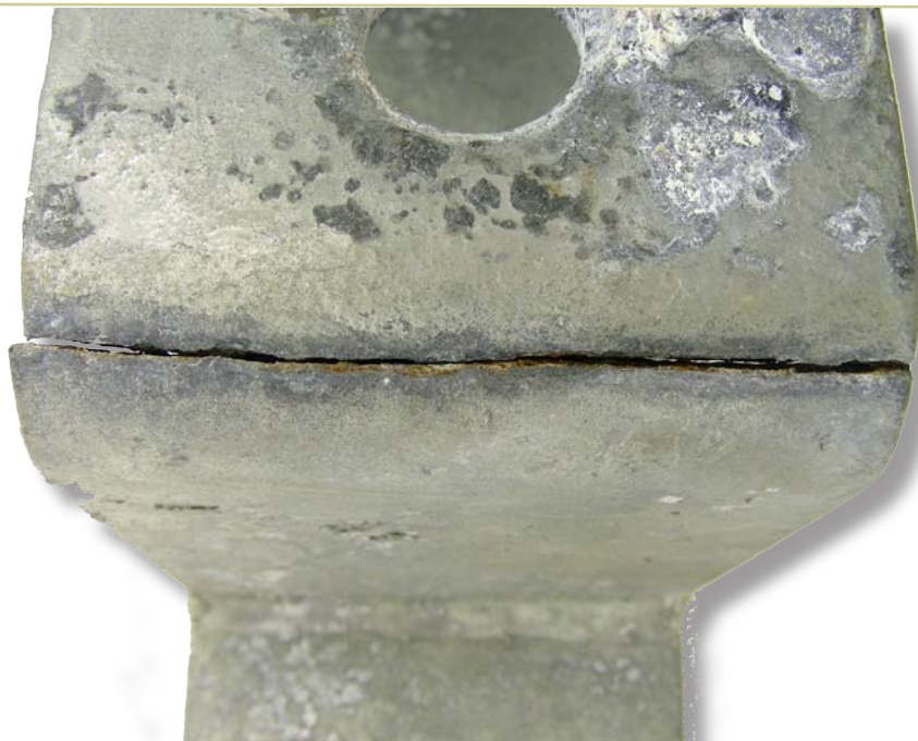
FIGURE 3 : Pièce d'attache fissurée (détail de la fissure)
