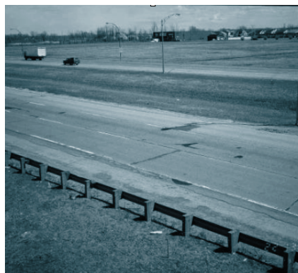
Figure 1 – Dégradations présentes sur l'ancienne chaussée
