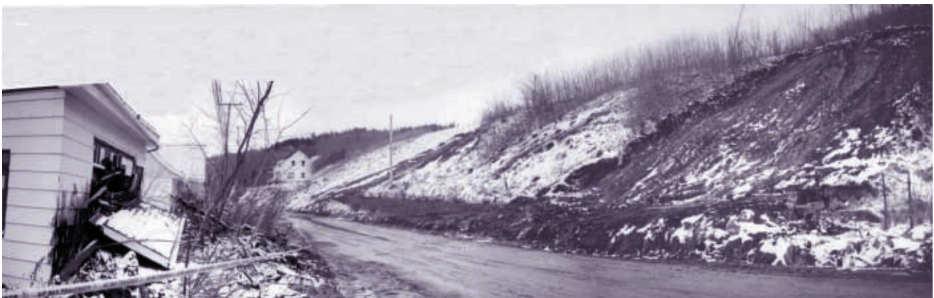
Figure 1 : Exemple d'un glissement superficiel et de l'effet des débris.
