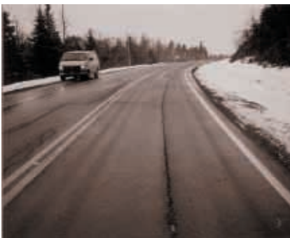
Photo 5 : Fissure longitudinale, centre de la voie (Route 255)
