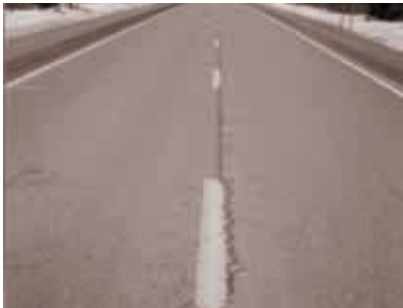
Photo 4 : Fissure longitudinale, centre de la chaussée (Route 165)
