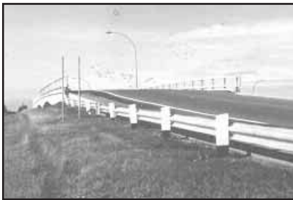
Figure 3 : Problèmes associés au tassement (cahot et dispositif de retenue inadéquat à l'approche de la structure).
