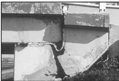
Figure 4 : Problèmes associés au tassement (bris de la structure)
