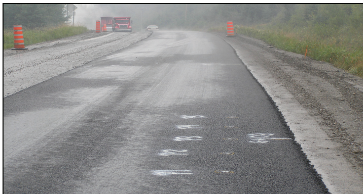
Figure 1 : Problème d'uniformité de texture lors de la pose
