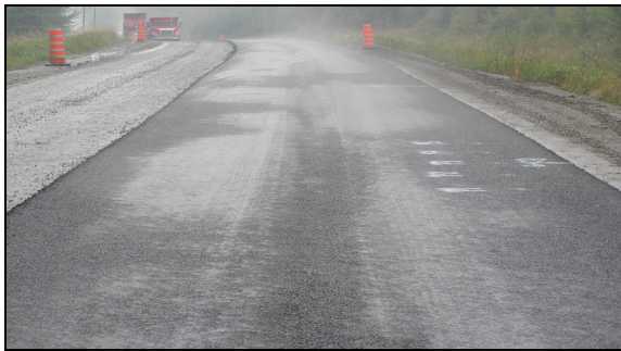
Figure 2 : Problème d'uniformité du revêtement (texture et densité)
