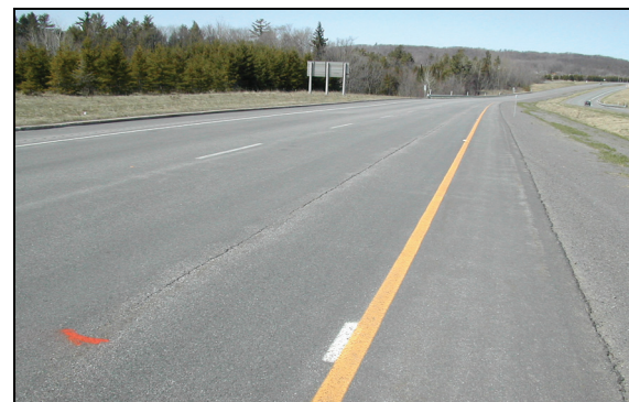
Figure 8 : Fissuration longitudinale au centre des voies
