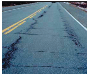
Fissuration en fatigue
