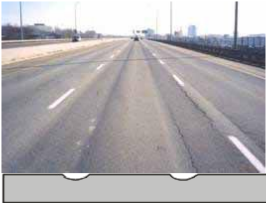
Photo 1 : Ornières simples à faible rayon
