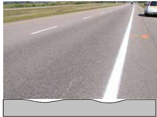
Photo 4 : Ornières à grand rayon
