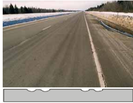
Photo 2 : Ornières doubles à faible rayon
