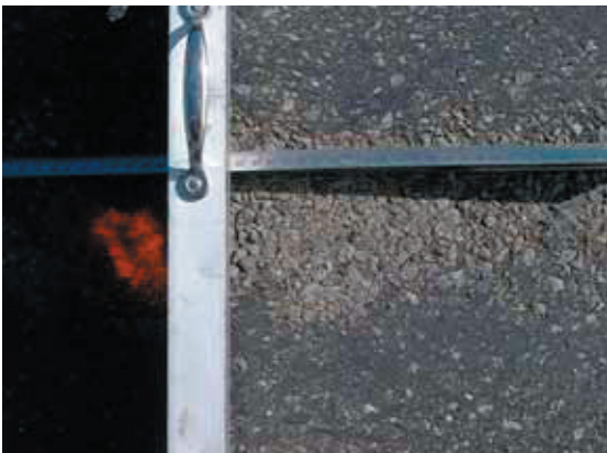
Photo 2 : Cas sévère de contamination dans une trace de roues
