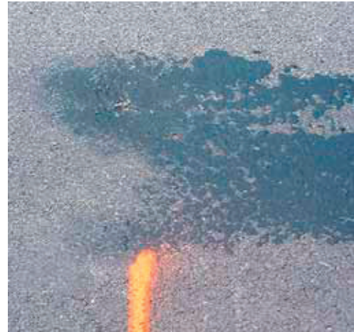
Photo 1 : Remontée de bitume en raison d'une contamination
