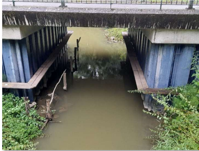
Illustration 16 : Banquettes petite faune aménagées dans l'ouvrage hydraulique le long de la Petite Beuve
