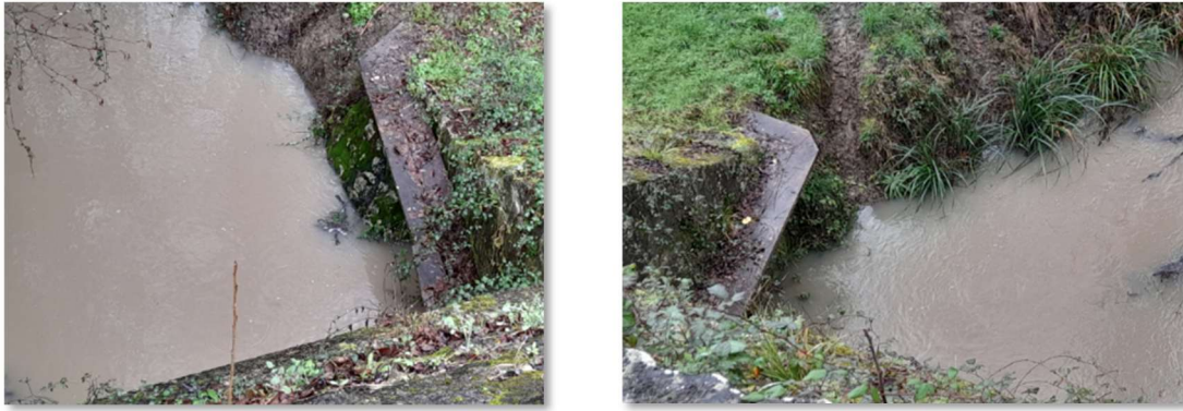
Illustration 87 : Banquettes en bois, rive droite et rive gauche le long du ruisseau du Cabossin sous la RD 247
