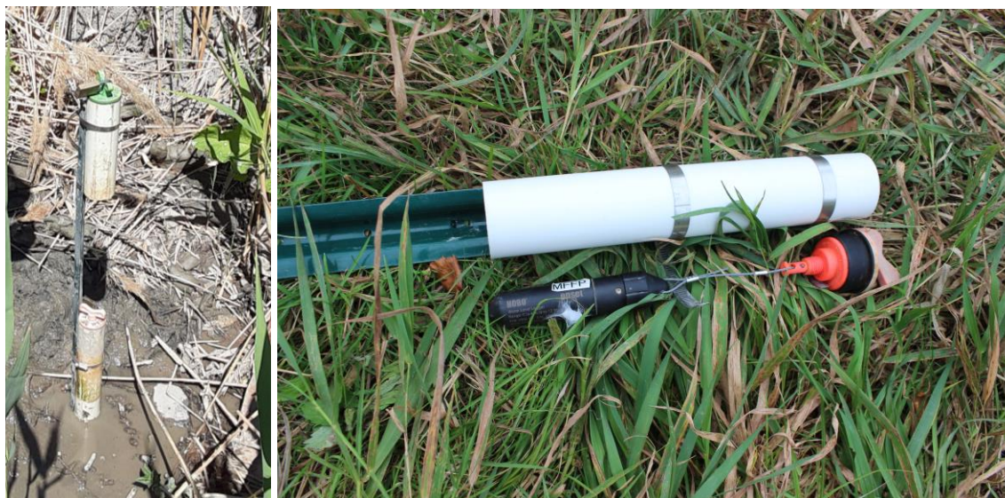
Figure 7 : Installation d'un enregistreur de base au-dessus du piézomètre
