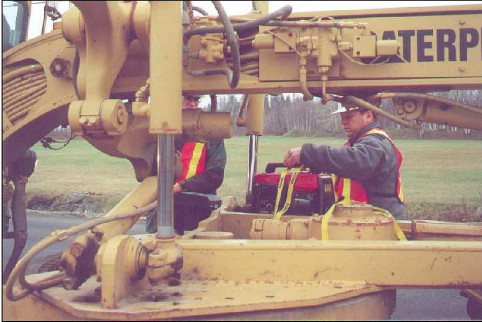
Figure G11 L'installation d'une pompe d'échantillonnage de l'air ambiant sur la niveleuse.
