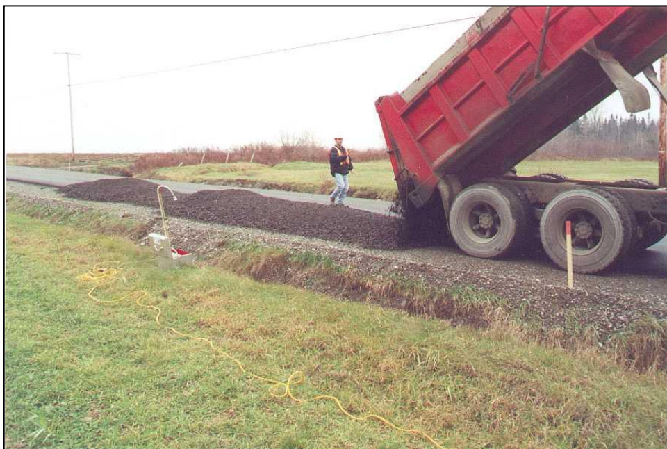
Figure G7 Déchargement du camion à benne transportant les résidus de type EBFA sur l'accotement de la route désignée. À la gauche, noter la station de monitoring de la qualité de l'air pour l'amiant.
