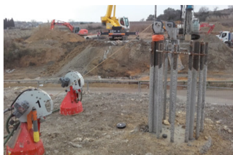
d) Exemples de tubes trop élevés par rapport à la plateforme
