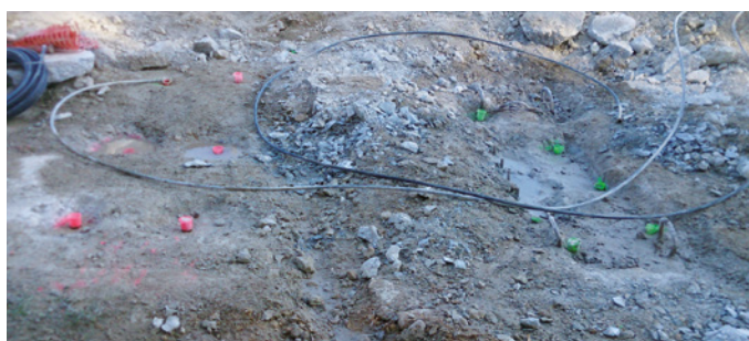
e) Tubes repérés sommairement (point vert) et ne dépassant pas de l'élément de fondation et problématique de stagnation d'eau sur la plateforme de travail
