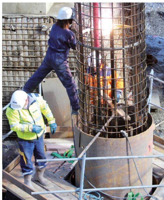
Figure 5.73 : Soudage pour assemblage de tronçons de cage - Posture de travail interdite
