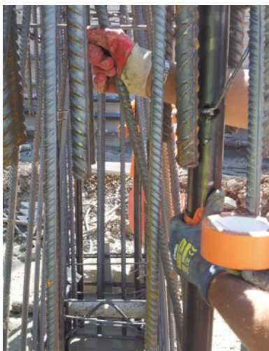
Figure 5.66 : Difficulté de raccorder les tubes en raison de l'encombrement
