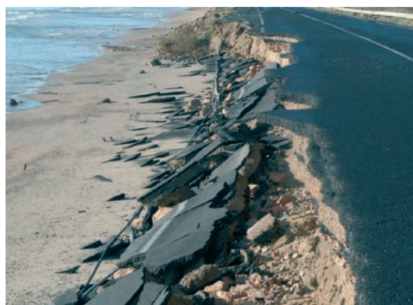
Érosion route Sète à Marseillan - Source : www.Thau-agglo.fr
