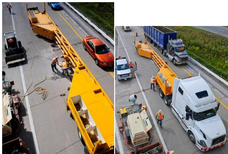
Photo 7 : Camion-remorque avec cage de protection ( mobile barriers ) – source : QMB inc.
