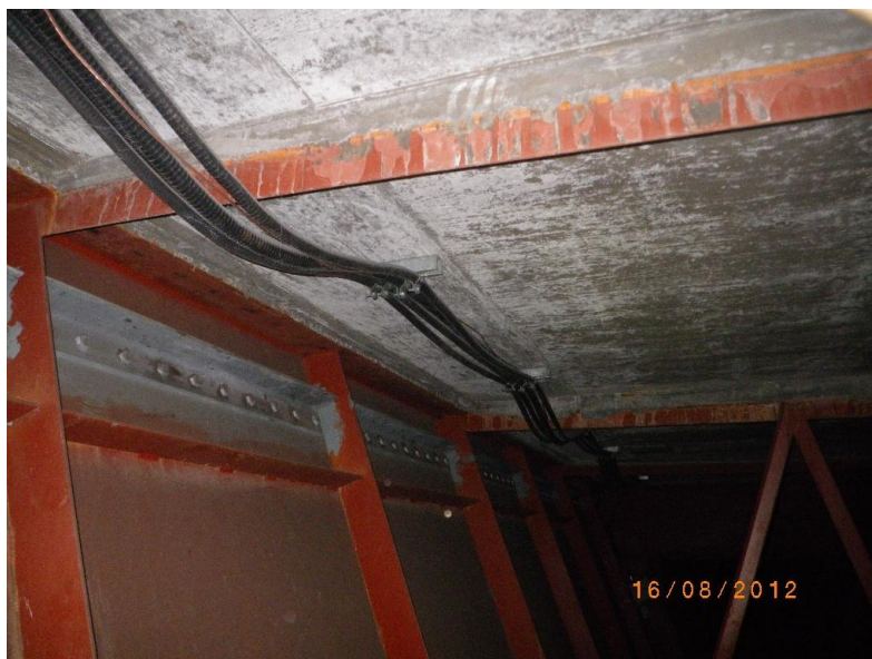
Photo 9 : Conduits électriques à l'intérieur des poutres caisson, photo inspection Roche 2012-08-16
