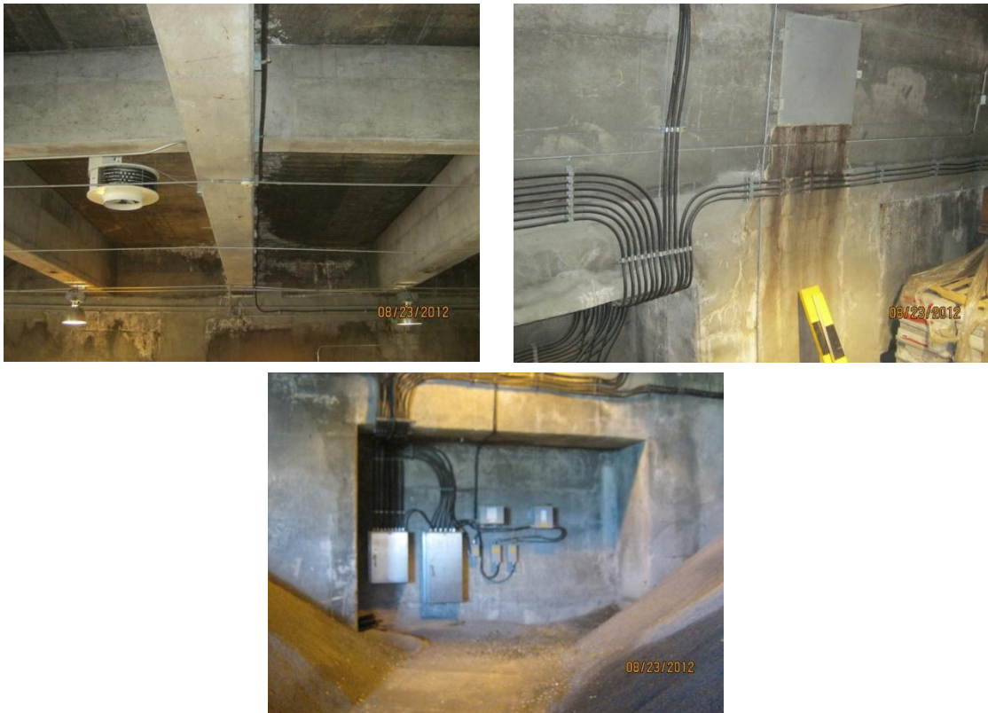
Photo 10 : Conduits et systèmes électriques à l'intérieur des culées creuses, photos inspection Roche 2012-08-23
