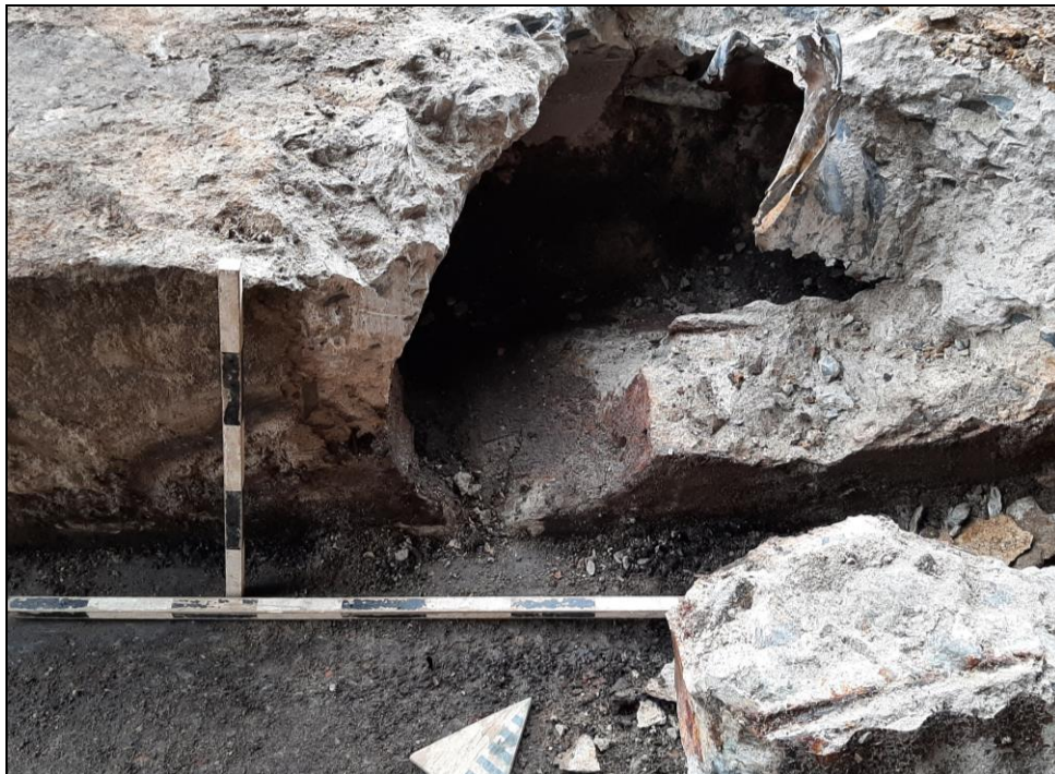
Photo 25. Cavité observée dans la branche ouest du vestige 1B100, vers le nord-ouest (MTQ-154-16-0429-2022-198)
