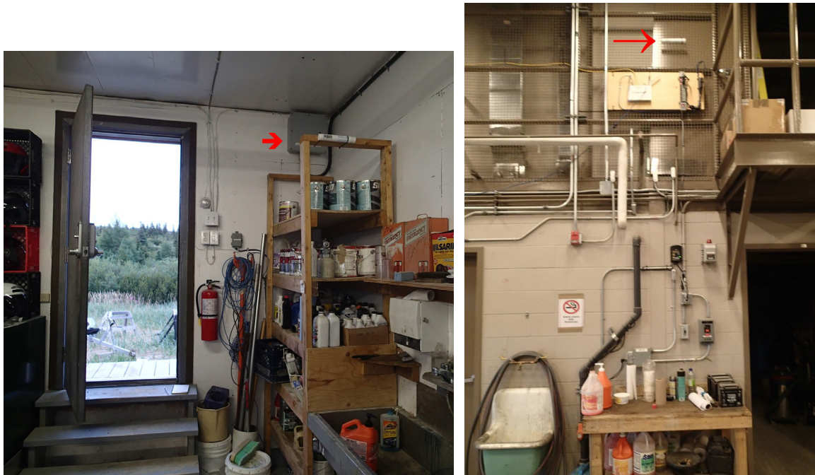
Figure 9. Installation des baromètres enregistreurs : (gauche) au sommet d'une étagère dans le garage de la station de recherche du CEN à Kuujjuarapik; (droite) sur un grillage de la mezzanine du garage de l'aéroport de Quaqtaq (seulement à partir d'août 2018).
