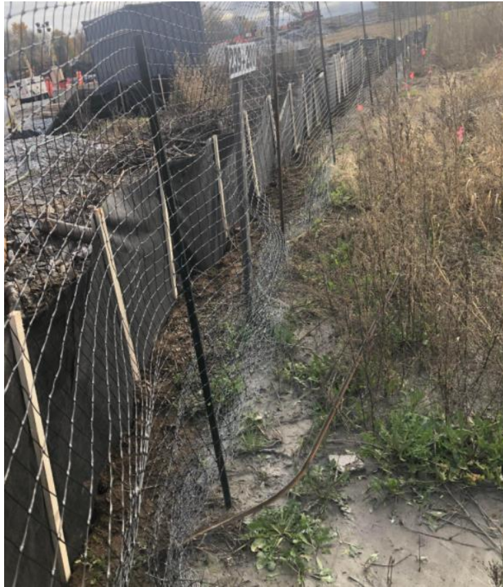
Figure 44. Bris de l'exclos du MR8 réparé temporairement
