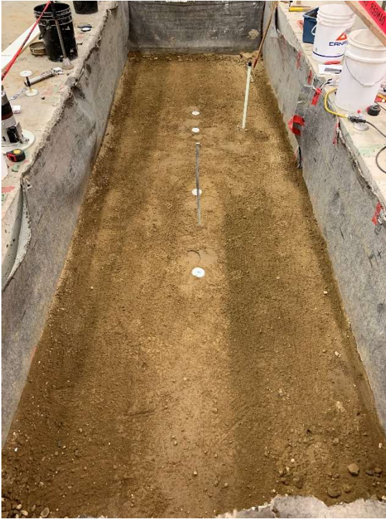
Figure 67. Capteurs de déformation verticale installés dans le sol d'infrastructure
