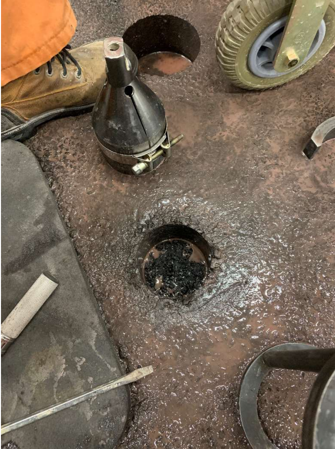
Figure 82. Résultat du décollement du bi-couche obtenu lors de la réalisation de l'essai AMAC
