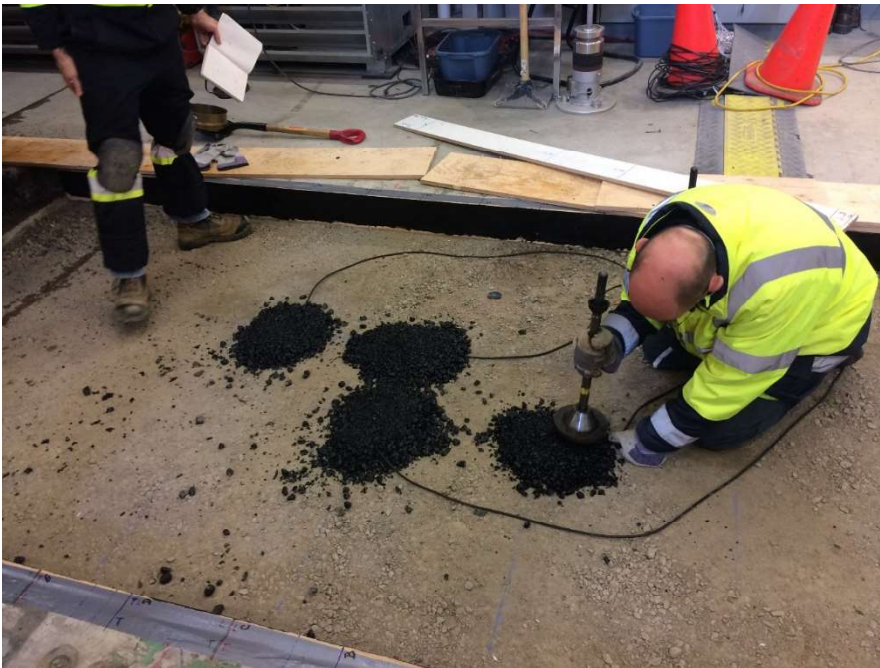
Figure 70. Installation des capteurs TML à la base de la couche de GB20
