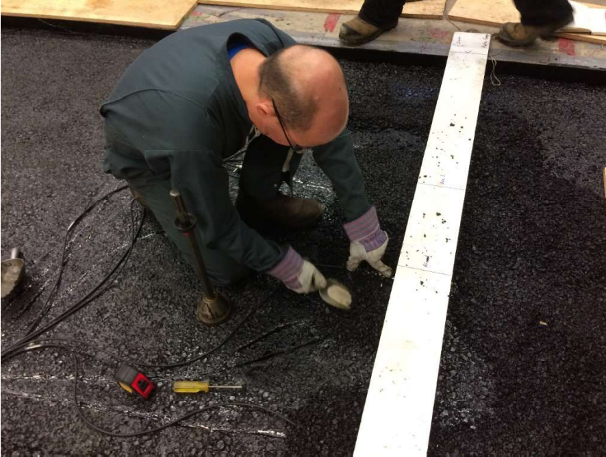
Figure 71. Installation des capteurs TML à la base de la couche de ESG10
