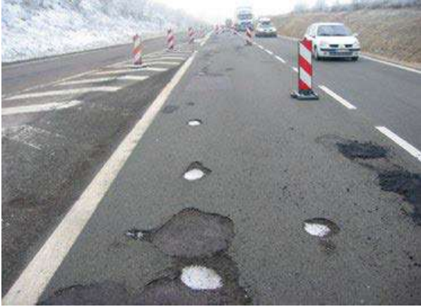
Figure 2. Formation subite de pelades et chapelets de nids de poule en période hivernale, ayant nécessité la fermeture de la voie au trafic (Mauduit et al., 2013)
