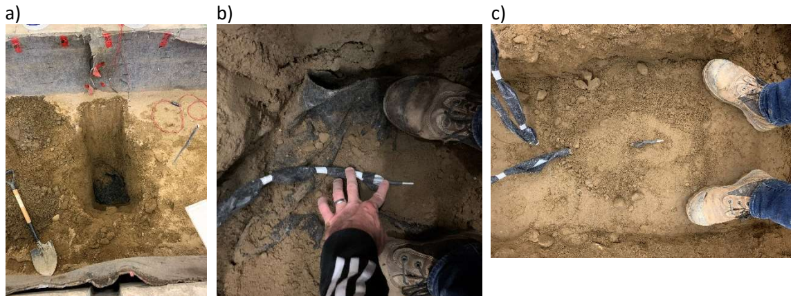
Figure 54. Installation des thermistances dans le sol et les matériaux granulaires, a) excavation dans le sol d'infrastructure, b) Positionnement de la thermistance au bas de la fosse, c) Installation des thermistances dans le sol
