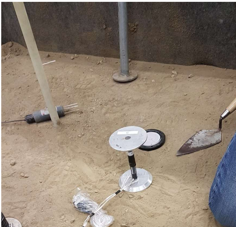
Figure 64. Capteur de déformation verticale
