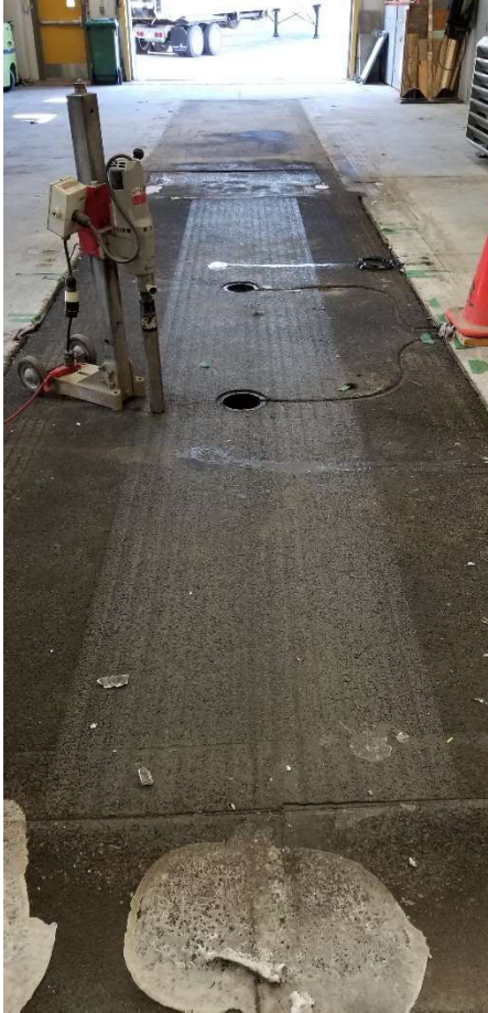
Figure 15. Séparation de la fosse en deux sous-sections ayant des caractéristiques différentes (épaisseur d'enrobé bitumineux est différente dans le cas présenté)
