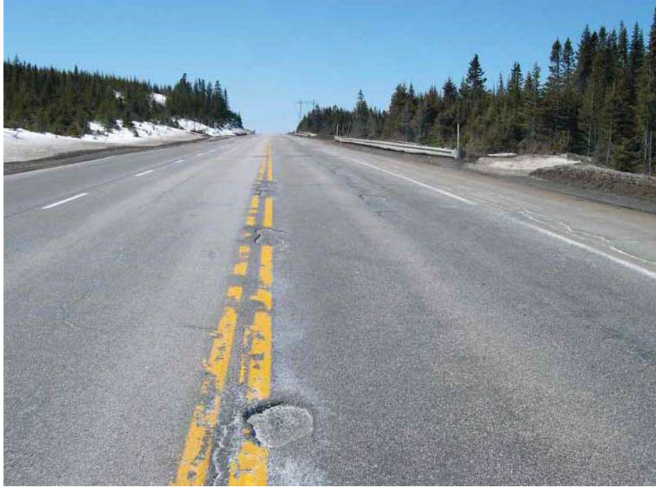
Figure 3. Pelade sur une chaussée flexible (Ministère des Transports du Québec, 2007)
