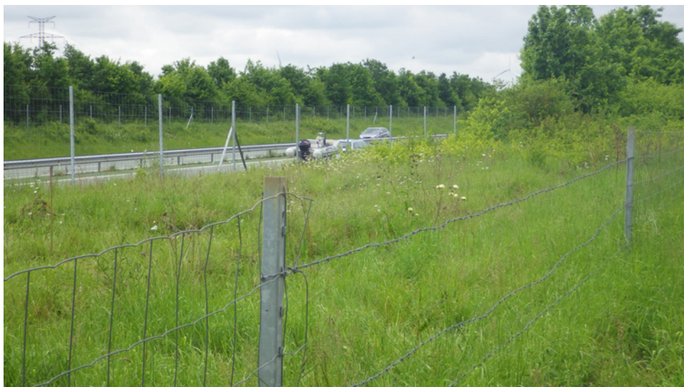
Illustration 5 : Ancienne clôture faune démontée et remplacée par du fil de ronce Crédit : Cerema – Christophe Pineau.
