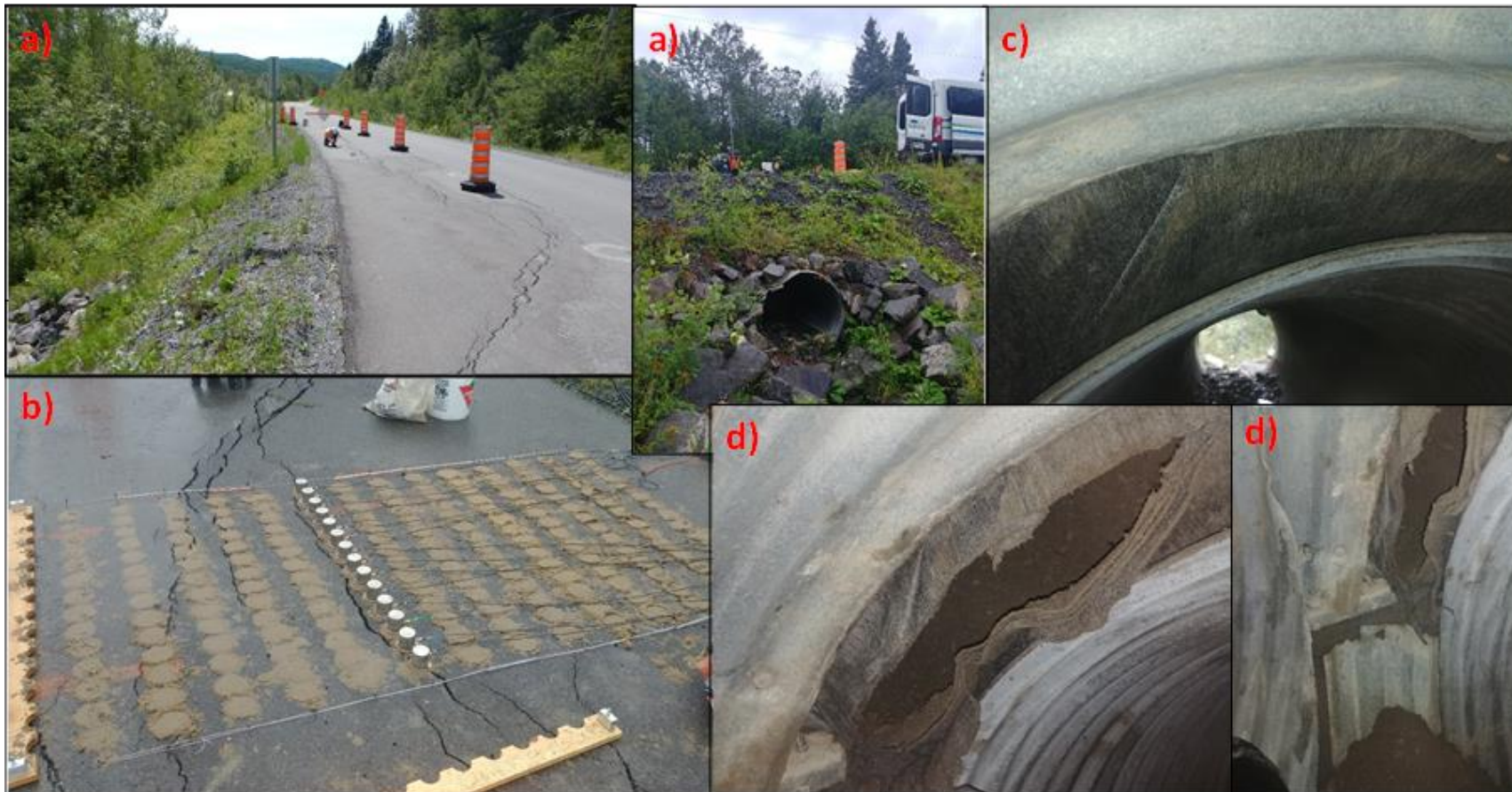
Figure 9.2. a) Vue globale du site expérimental de saint-René-de-Matane. b) Emplacement des relevés par rapport aux fissures visibles dans le pavé. Notez que les 14 capteurs se trouvent le long de la ligne 9. c) Entaille du ponceau provoquée par le glissement de la voie inspectée, et à travers laquelle la cavité a été créée, d) déchirement du géotextile, et création de la cavité par prélèvement du sol.
