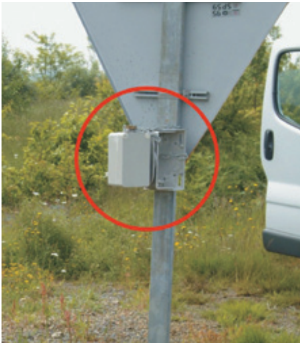
Compteur « radar » : il reste très discret derrière un panneau
