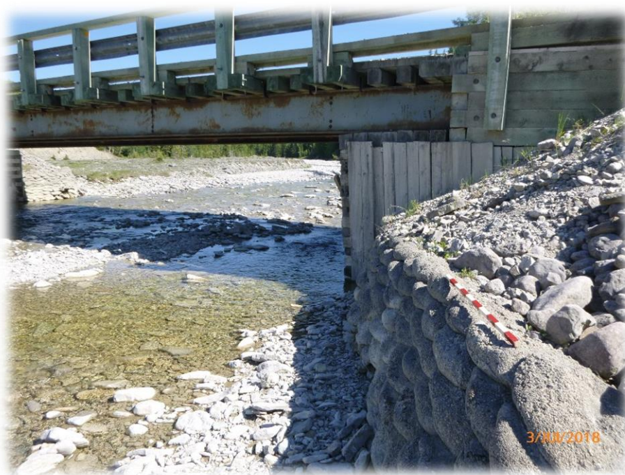
Figure 43 : Vue générale de l'étalement contre l'érosion en sac de béton mis aux abords du pont actuel de la rivière à la patate Est du côté ouest et de l'ancienne culée de pont en bois, à l'est de la zone 4. Projets 154-13-0032 et 154-13-0033 (Photo 154130033_180703_057).
