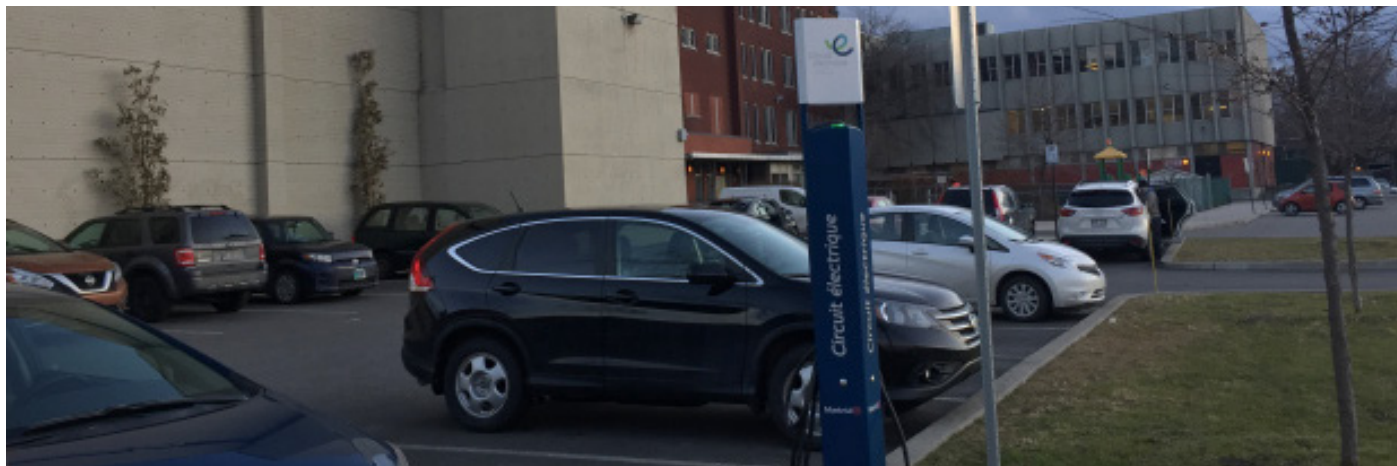
Source : Journal Metro, borne de recharge du stationnement du Centre Roussin
