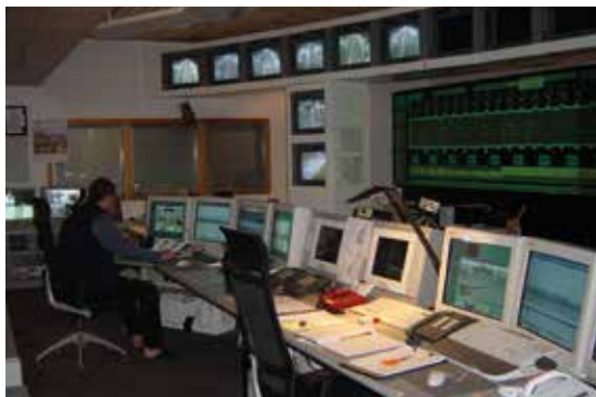
Le tunnel du Mont-Blanc : un exemple d'infrastructure vitale affecté par la catastrophe du 26 mars 1999. Photo : Cetu
