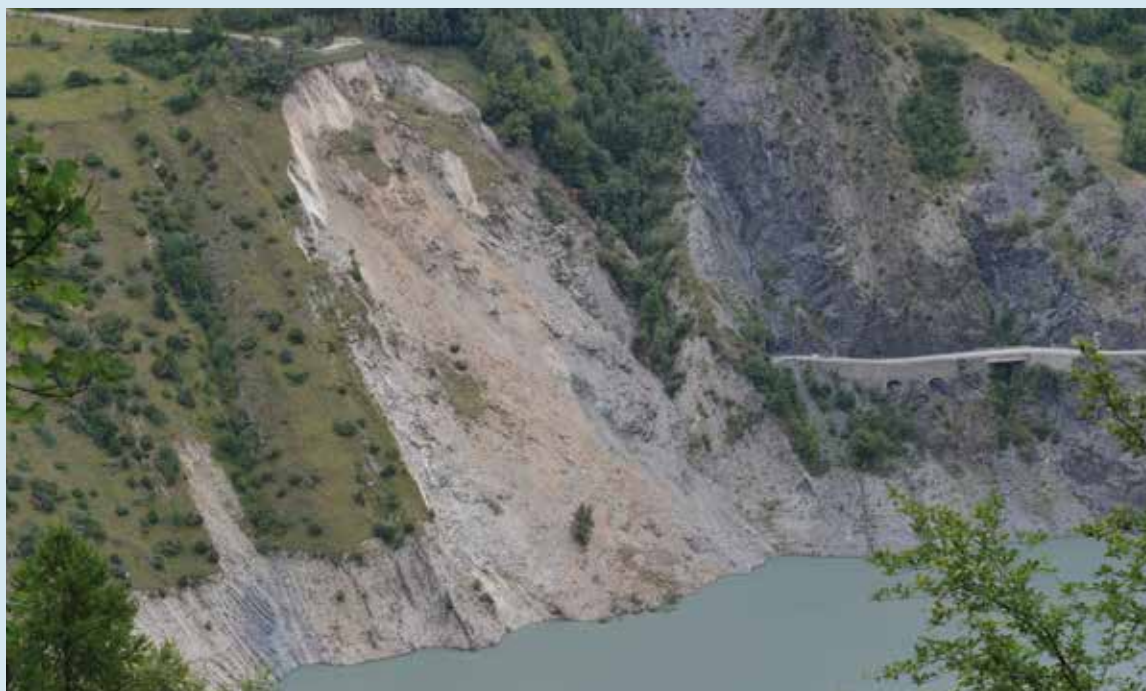
Glissement du Chambon et isolement de la vallée. 2015. Photo : Cerema CE
