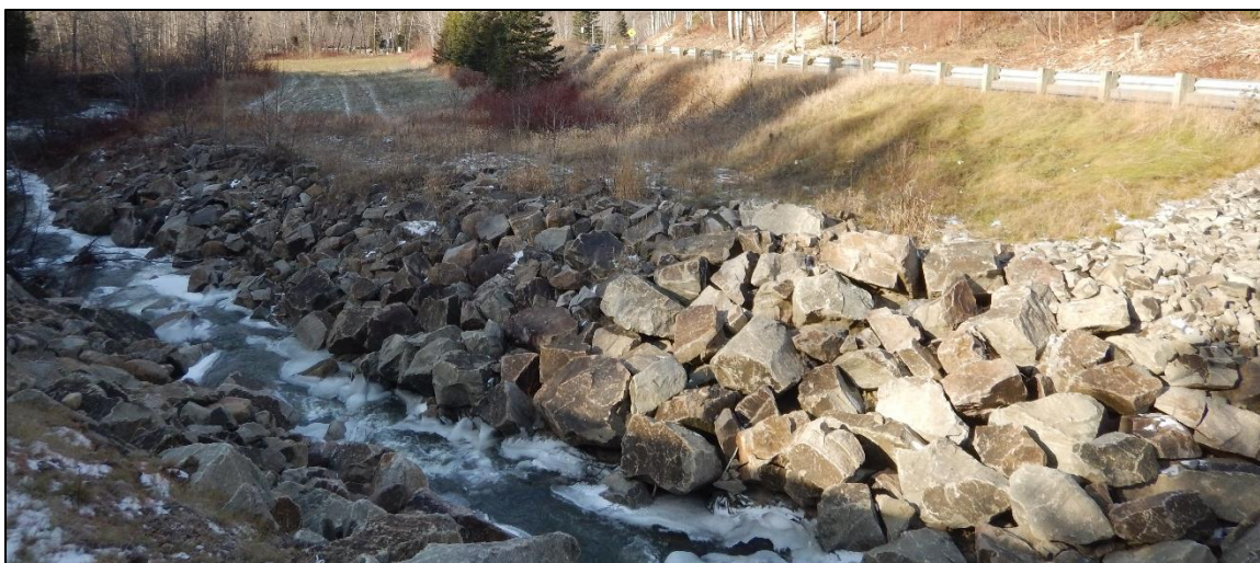
Photo 25 : Projet 154-12-0587, vue du secteur 4 depuis le secteur 2, enrochement considérable de la limite sud débordant sur les surfaces de sols à expertiser, direction nord-ouest.
