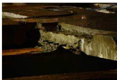
Figure 6.27 Section H-H – Béton moyennement corrodé
