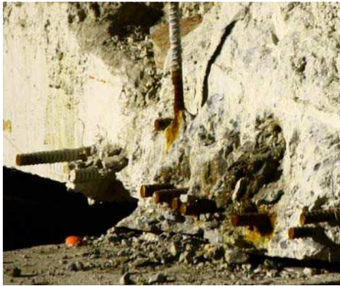
Figure 6.20 Section A-A – Corrosion des barres d'armature et rouille du béton
