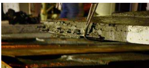
Figure 6.28 Section I-I – Béton moyennement corrodé et fissures visibles
