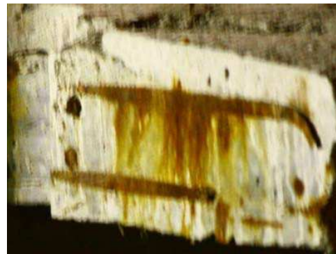
Figure 6.23 Section D-D – Corrosion et rouille des barres d'armature
