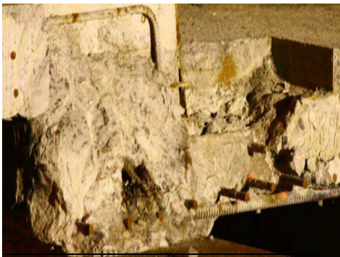
Figure 6.22 Section C-C – Corrosion des barres d'armature et délamination
